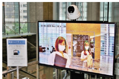
本店ビルのエントランス付近に通行者の体温を測定するモニターを設置
