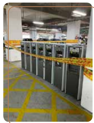
水源 A 棟 / 修齊會館 D 棟飲水機汰換更新
