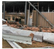
米拠点を襲ったトルネードの被害
