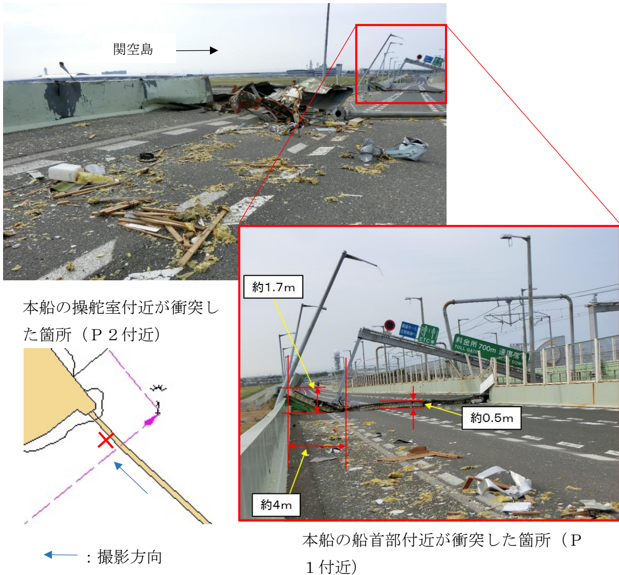
図6 本件連絡橋上の損傷状況
