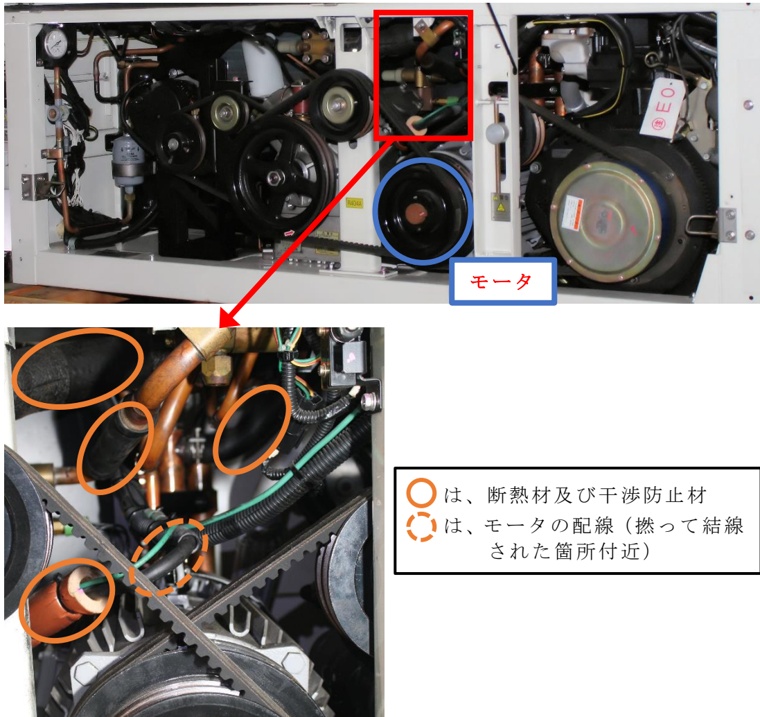
写真7 同型の冷凍機の状況
