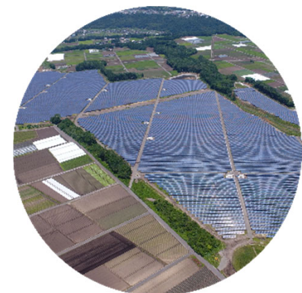
いちご昭和村生越ECO発電所
