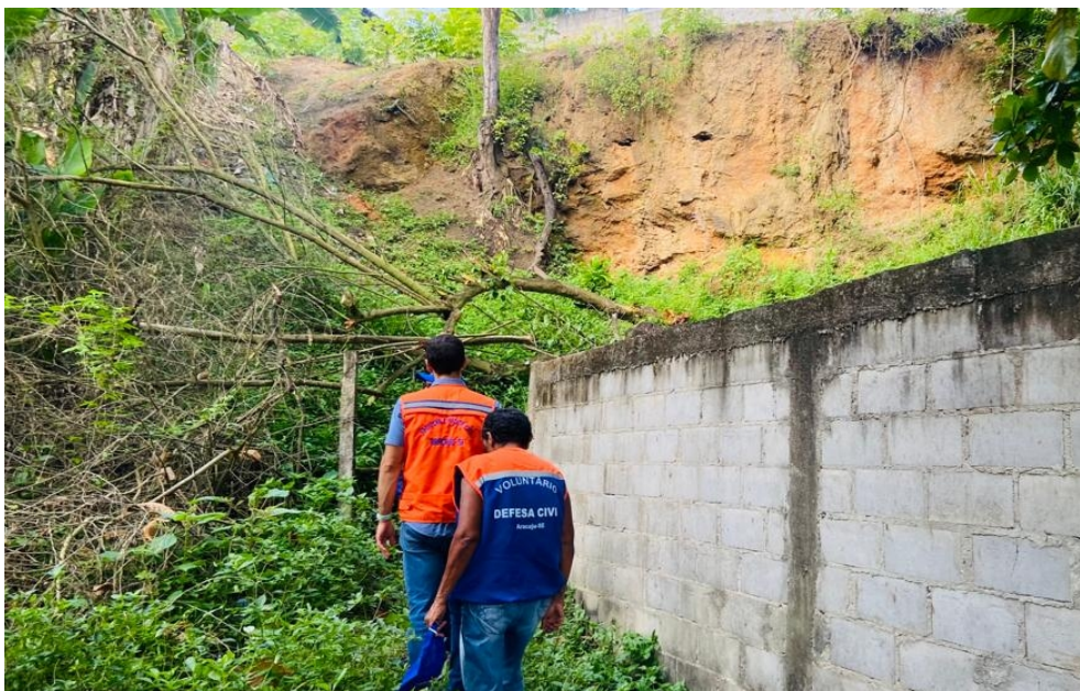
IMAGEM 6 – Monitoramento participativo de área de risco para deslizamento de terra (NUPDEC América, 2023).
