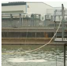
马洪工厂改善废水回收处理装置
