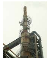
马洪工厂脱硫塔
