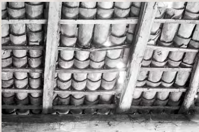
29. Une latte a rompu, la rupture n'est pas loin.
