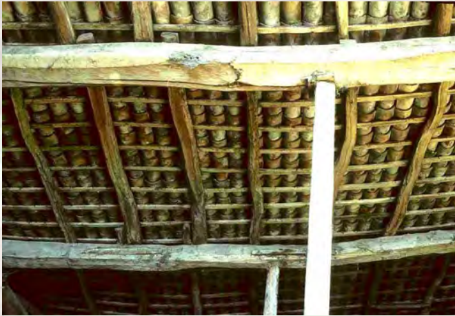
27. Deux ruptures de pannes.
