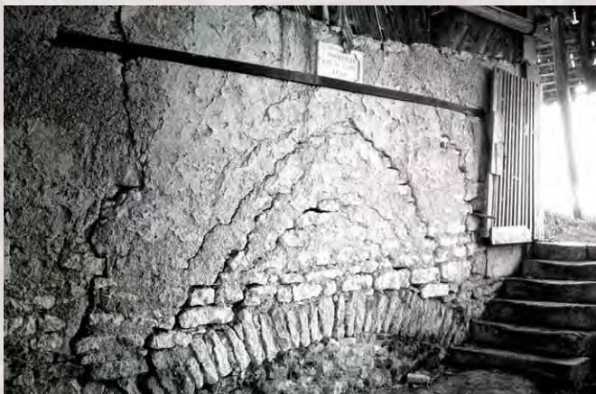
12. Fissurations venues de l'affaissement de la voûte du four.
