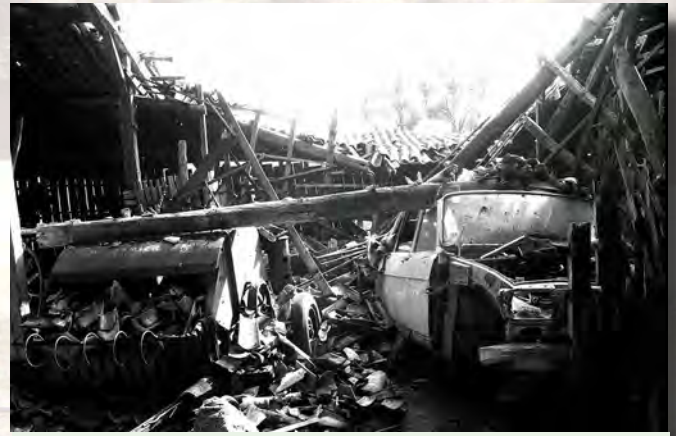
28. L'effet d'une partie de toiture qui s'écroule.
