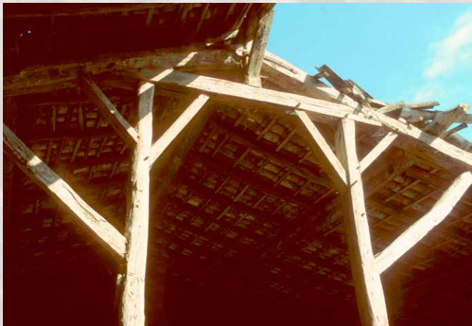
23. Les hommes-debout sont doublement triangulés avec les arbalétriers, en raison de leur position assez rapprochée l'un de l'autre.
