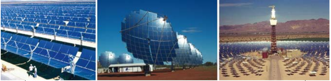
A sinistra specchi parabolici lineari, al centro specchi parabolici circolari, a destra eliostati a torre
