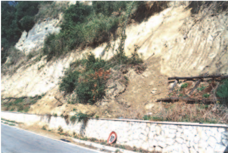
Foto 1: Frana superficiale verificatasi post-operam e ricoprente parte della grata, aprile 2003. Foto di A. D'Andrassi
