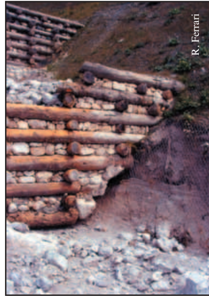
Foto 24.2: Insufficiente ammorsamento laterale dell'opera (briglia viva in legname e pietrame) al substrato con conseguente parziale scalzamento laterale
