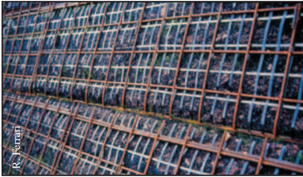
Foto 24.9: Mancanza di adeguato strato di terreno vegetale tra il materiale inerte litoide di riempimento ed il paramento esterno della struttura (terra rinforzata rinverdita(?)): la vegetazione non ha possibilità di attecchimento
