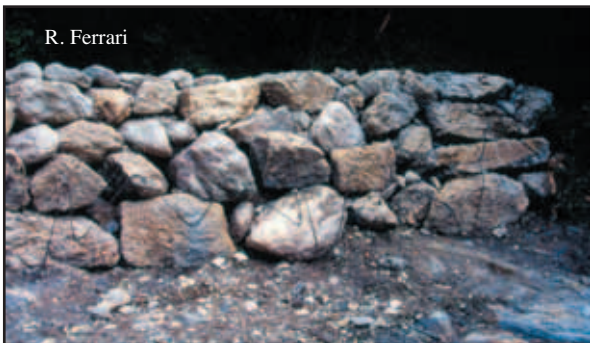
Foto 24.10: Errata legatura a zig-zag di massi (blocchi incatenati): non è garantita la reciproca stabilità
