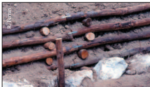
Foto 24.13: Mancato sincronismo costruttivo con errata scelta del materiale di riempimento (palificata viva doppia spondale): ormai l'inserimento della componente vegetale viva è impossibile; da notare inoltre la mancanza di incastri della paleria e la chiodatura con piccoli chiodi battuti. Quale sarà l'evoluzione di questo intervento?
