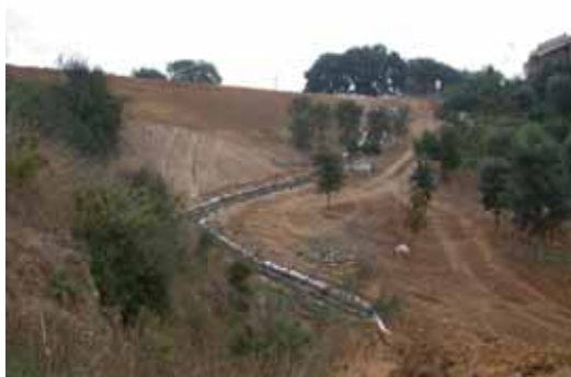
FOTO 4 : Visione di una zona degli interventi nella prima fase di sagomatura delle superfici e di sistemazione del compluvio principale con canale in pietra e legno - D. Dallari
