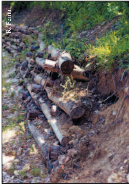
Foto 24.1: Mancata esecuzione di adeguato raccordo tra opera (palificata viva doppia) e substrato con conseguente innesco di fenomeni erosivi
