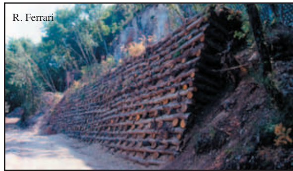
Foto 24.15: proporzioni non adeguate alla tipologia (palificata viva doppia) con conseguente vanificazione delle funzioni portanti ed assenza di componente vegetale viva
