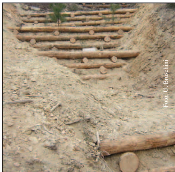
Foto 20.7: Consolidamento di solco d'erosione con palificate in legname di castagno, in fase di ultimazione - loc. Tosse, Spotorno (SV)
