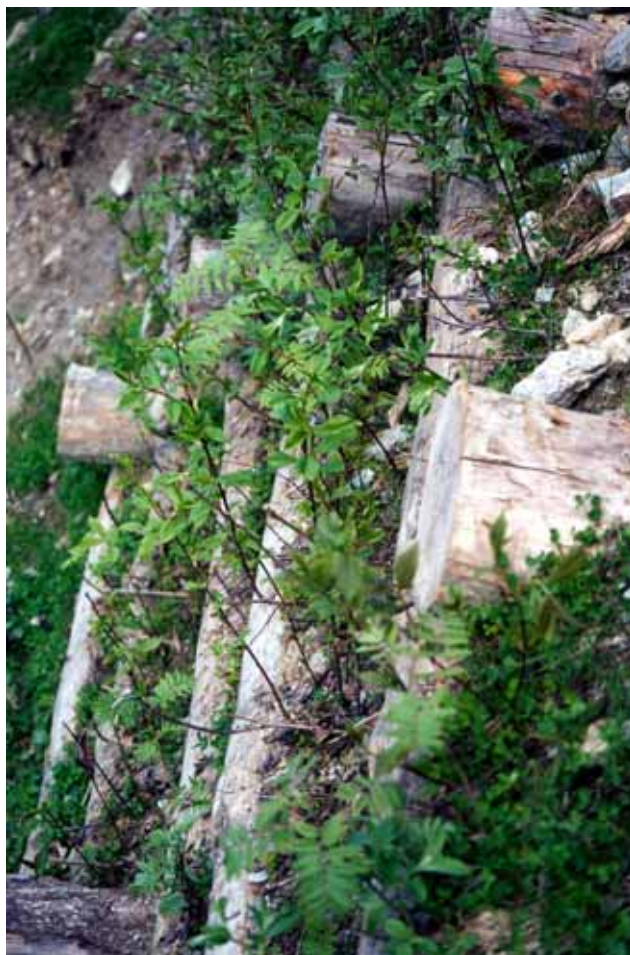
Palificata viva doppia di versante, con messa a dimora di piante radicate ( Sorbus aucuparia , Prunus padus , alnus incana , Salix caprea ) Strada per lo Stelvio (BZ), 2004
