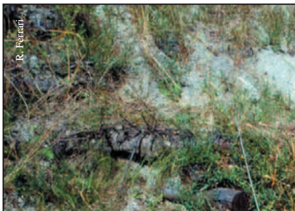
Foto 24.5: "Manutenzione" rivolta all'infrastruttura e all'opera (palificata viva doppia) preposta a sua protezione, effettuata con mezzi non idonei: la stessa struttura risulta fortemente danneggiata
