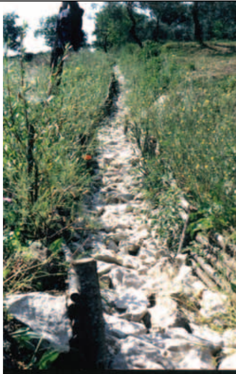
Foto 2: Canaletta in legname e pietrame ad un anno dalla realizzazione, maggio 2004. Foto di C. Milanese
