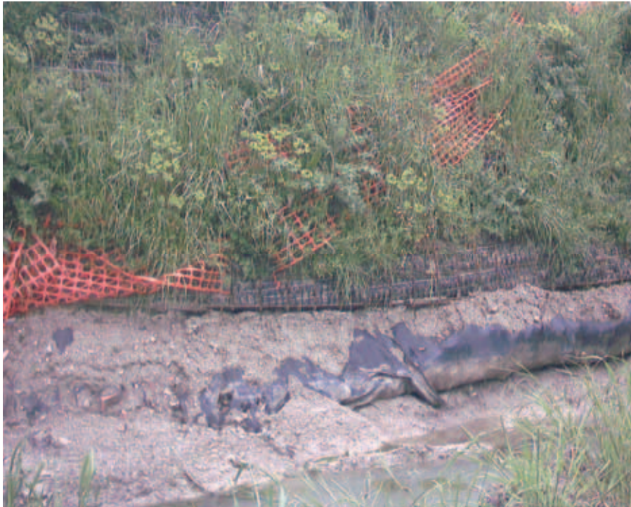
Foto 3: Terra armata con rinverdimento spontaneo e acqua di ristagno idrico al piede, maggio 2004. Foto di A. D'Andrassi
