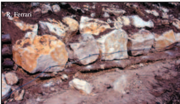
Foto 24.11: Posa di massi (blocchi incatenati) senza loro affogatura nell'alveo: l'acqua ha già approfondito ed intaccato la sede di appoggio
