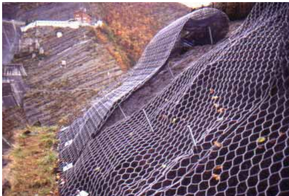
Rivestimento vegetativo a materasso Diga di Ridracoli (FO)
