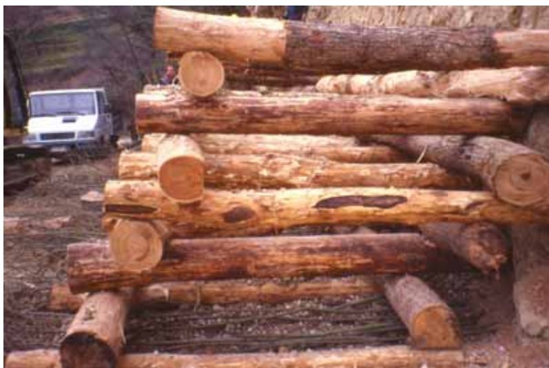
Foto 1: Struttura di una palificata viva doppia di consolidamento del piede della frana 1 (marzo 2000) - P. Cornelini
