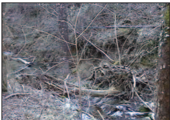
Foto 23.9: Presenza di vegetazione arborea sradicata in alveo.
