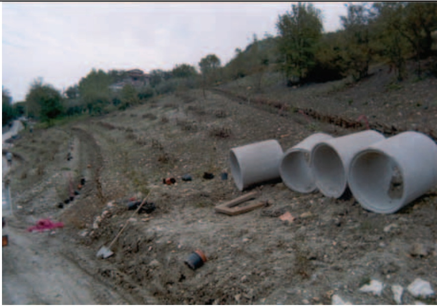
Foto 1: In-operam del versante in dissesto con palizzate e viminate vive, ottobre 2003. Foto di A. D'Andrassi.
