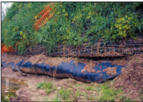
Foto 24.3: Mancata esecuzione di adeguato raccordo alla base dell'opera (terra rinforzata rinverdita) con conseguente scalzamento e parziale svuotamento della struttura
