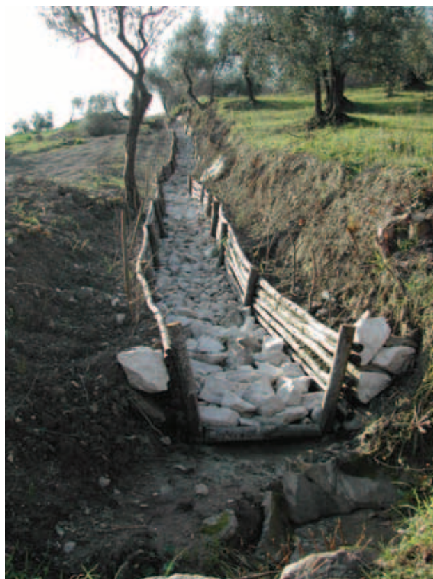
Foto 4: Canaletta in legname e pietrame in località Fontana del Pozzo, gennaio 2003. Foto di M. Amodio
