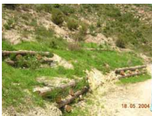
Foto 6: Sistemazione di piccoli solchi di erosione con brevi tratti di palificate a doppia parete, a circa 30-40 giorni dalla ripresa vegetativa – maggio 2004 - U.Bruschini
