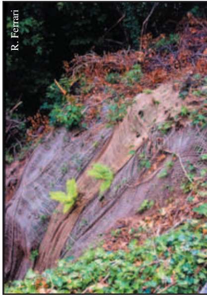
Foto 24.6: Errata modalità di posa (stuoia in juta): gli elementi non sono legati l'uno all'altro e non sono solidali con il substrato, vanificando l'azione protettiva
