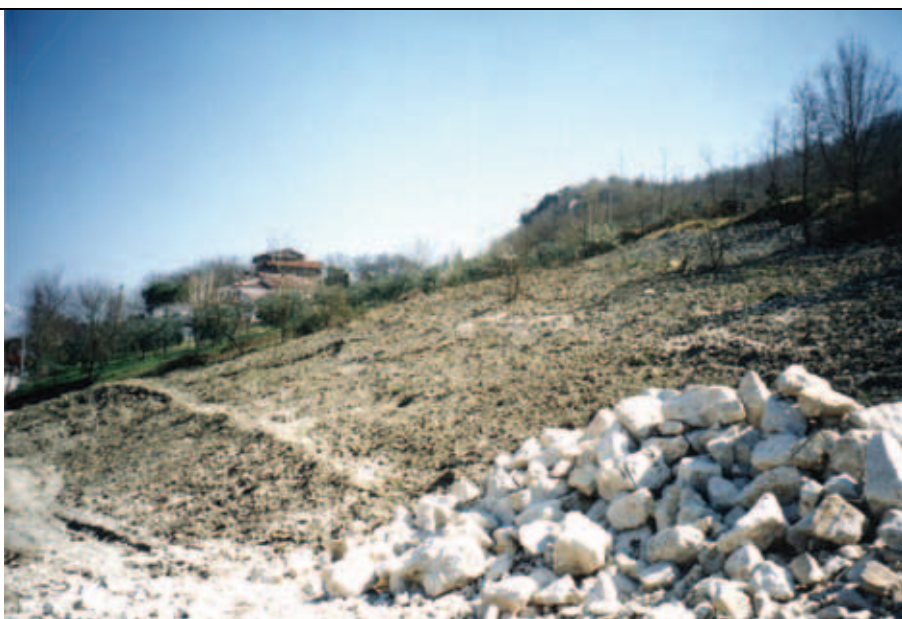
Foto 1: Ante- operam della parte di versante da sistemare con palizzate e viminate vive, marzo 2003. Foto di C. Milanese
