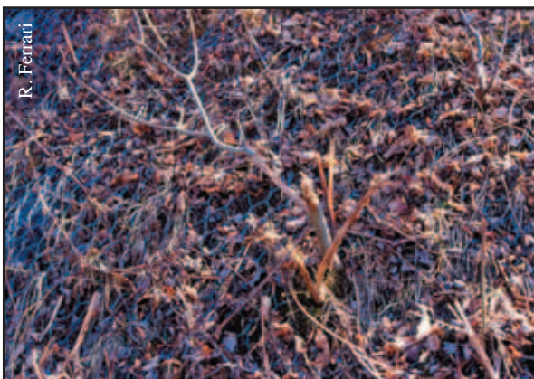
Foto 24.4: "Manutenzione" rivolta all'infrastruttura e non all'opera (rete metallica zincata a doppia torsione e biofeltro) preposta a sua protezione, effettuata con mezzi non idonei: la componente vegetale risulta irrimediabilmente danneggiata
