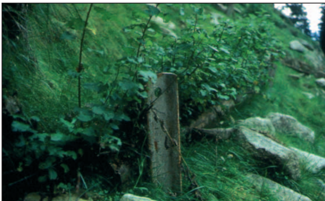
26) Cordonata viva con piloti dettaglio dopo 6 mesi; Val Passiria (BZ) Foto: F. Florineth
