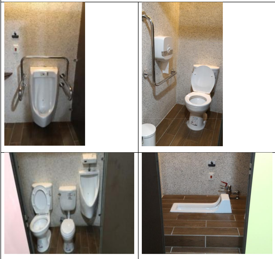
圖三 針對不同使用於不同廁間設置不同便器。(來源：內政部建築研究所，2015)
