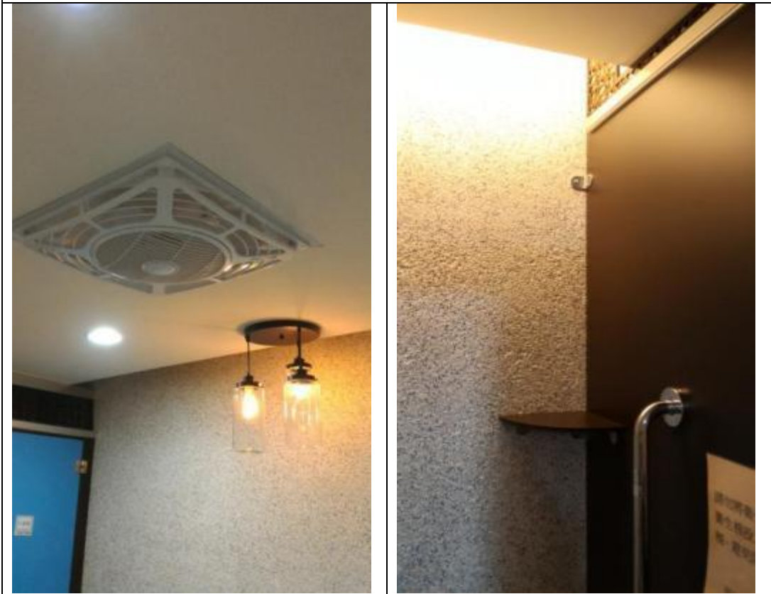
圖五 廁所內採機械換氣，減少廁所臭味。(來源：內政部建築研究所，2015)
