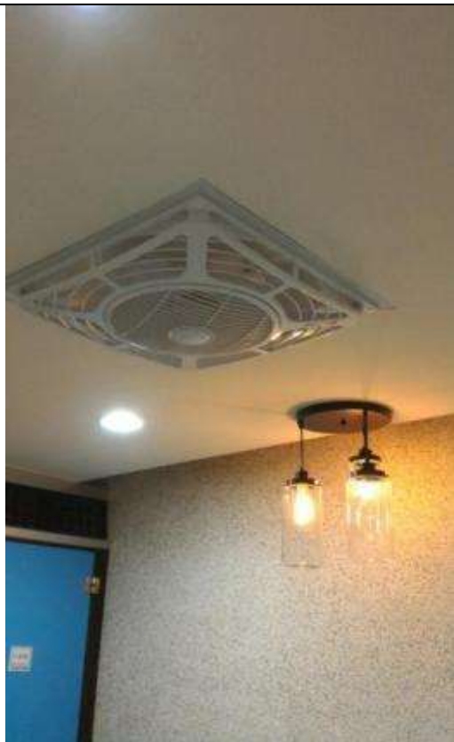
圖五 廁所內採機械換氣，減少廁所臭味。(來源：內政部建築研究所，2015)
