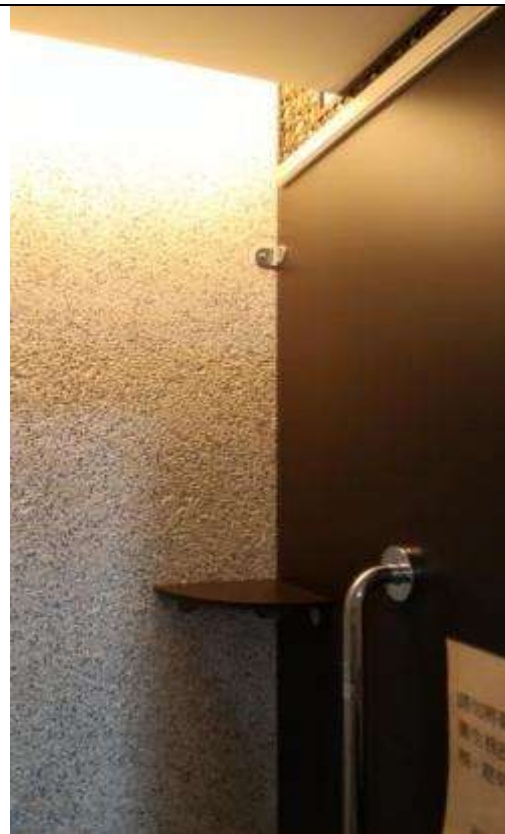
圖六 廁間內設置照明自動感光點減裝置，以節省電源及如廁安全感。(來源：內政部建築研究所，2015)
