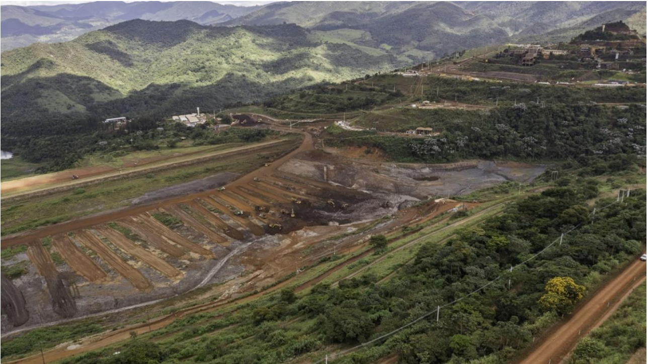
Foto 2. Vista área da Barragem de montante para jusante evidenciando a boa drenabilidade – abril/2024.
