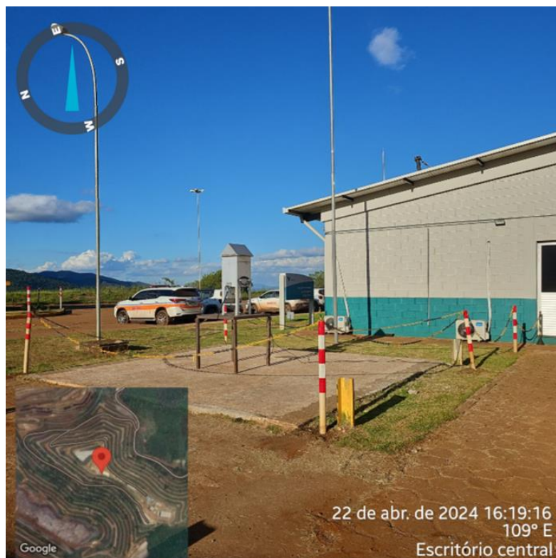
Foto 32: Piloto: instalação do equipamento Hivol para monitoramento da qualidade do ar (PTS) na obra (escritório central). Fonte: Vale, 2024.
