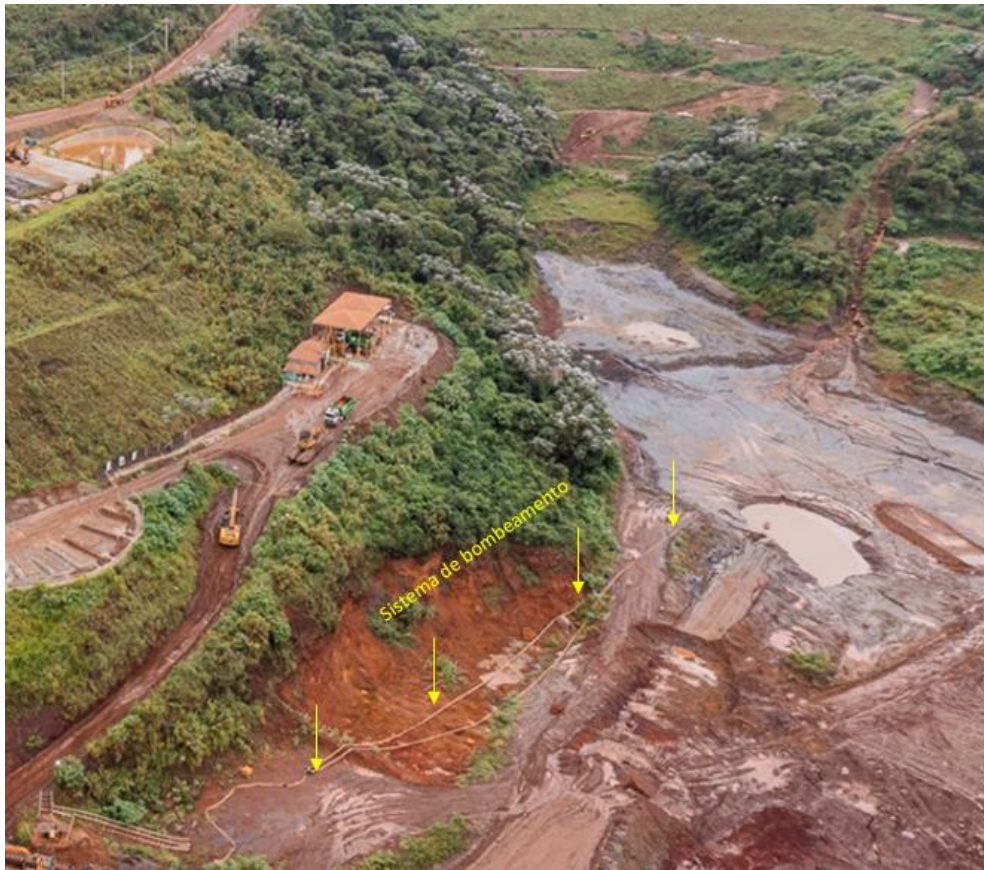
Foto 14: Aspecto geral do sump: sistema de Bombeamento instalado no sump da ombreira direita do reservatório (abril/2024). Fonte: Vale, 2024.
