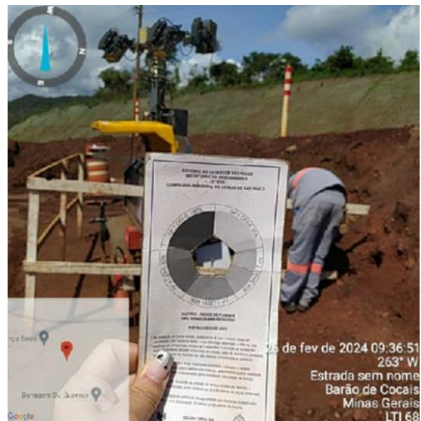
Foto 29: Controle de emissões em torre de iluminação (fev/2024).. Fonte: Vale, 2024.
