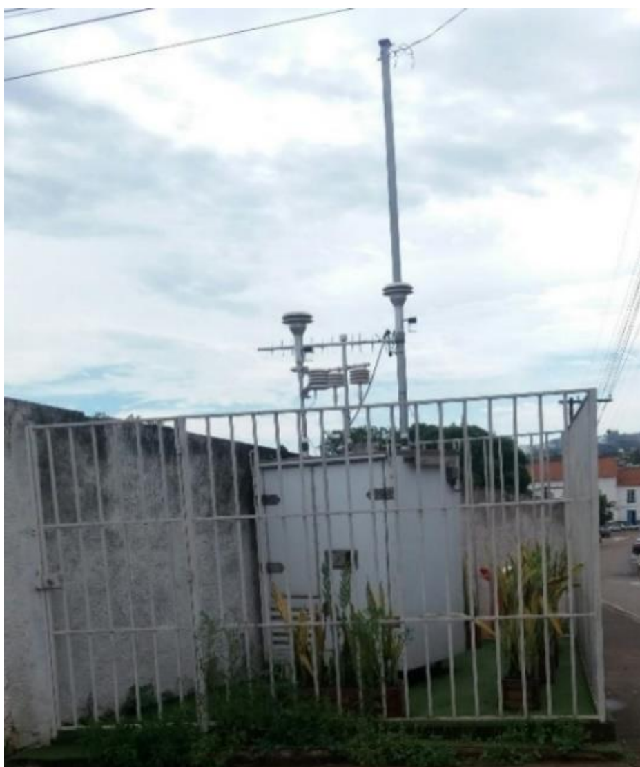
Figura 71 - Estação de monitoramento de Qualidade do Ar - Matriz. Fonte: Vale, 2024.
