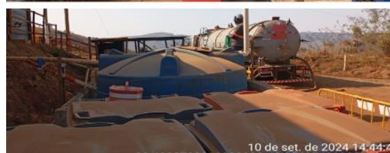
Figura 94 - Sucção de efluente sanitário armazenado nos tanques sépticos. Vale, setembro de 2024.
