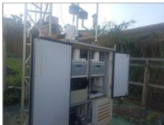
Figura 67 - Estação de Monitoramento de Qualidade do Ar de Pires.
