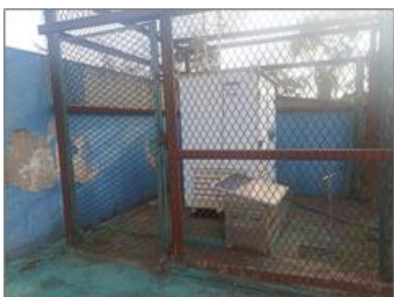
Figura 68 - Estação de Monitoramento de Qualidade do Ar de Mota. Fonte: Vale, agosto 2023.
