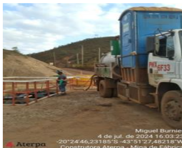
Figura 92 - Manutenção dos banheiros químicos disponíveis nas frentes de obra. Vale, julho de 2024.
