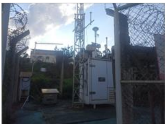
Figura 66 - Estação de Monitoramento de Qualidade do Ar de Pires.
