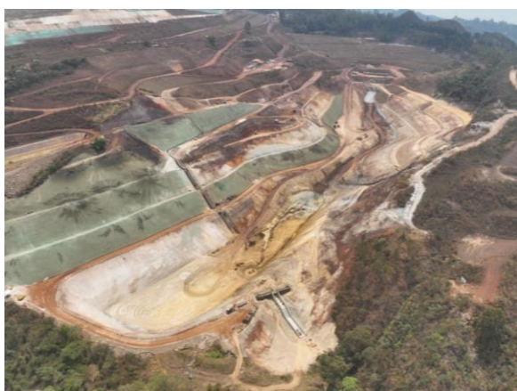
Figura 9 - Vista geral das obras de execução do PRAD, com vista para o SUMP e drenagem. (Fonte: Vale, outubro de 2024).
