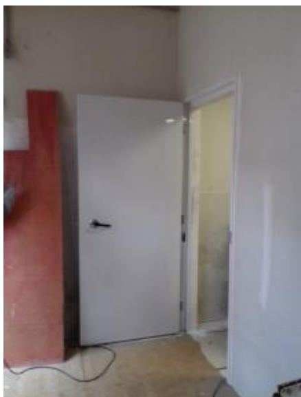
Porta corta fogo - acesso ao servidores do datacenter.
