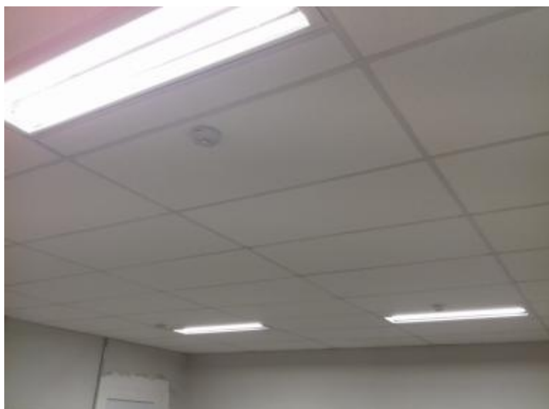
Luminárias e sensores de fumaça e temperatura.
