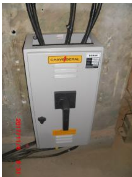
Secionadora rotativa a fusível, instalada no túnel do prédio antigo do CSA.
