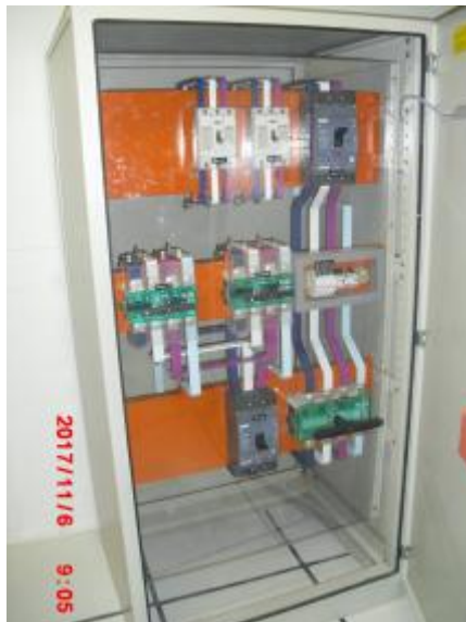
Parte interna do QD de Interligação dos nobreaks.
