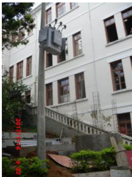
Instalação do poste do transformador, execução das bases de concreto do GMG, bases das condicionadoras de ar e parte do cubículo.
