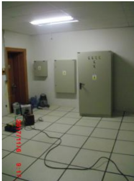
Piso elevado e quadros QDEE01, QDEE02 e QD de Interligação.
