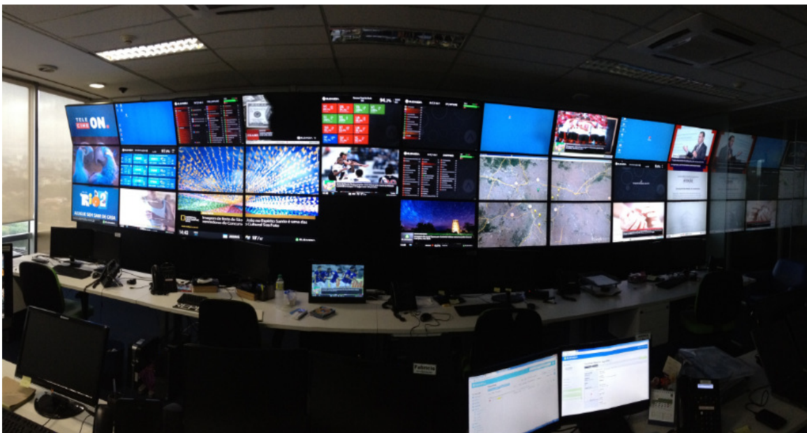
Sala de Monitoramento
