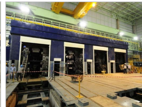
建設中の4スタンド 仕上圧延機
