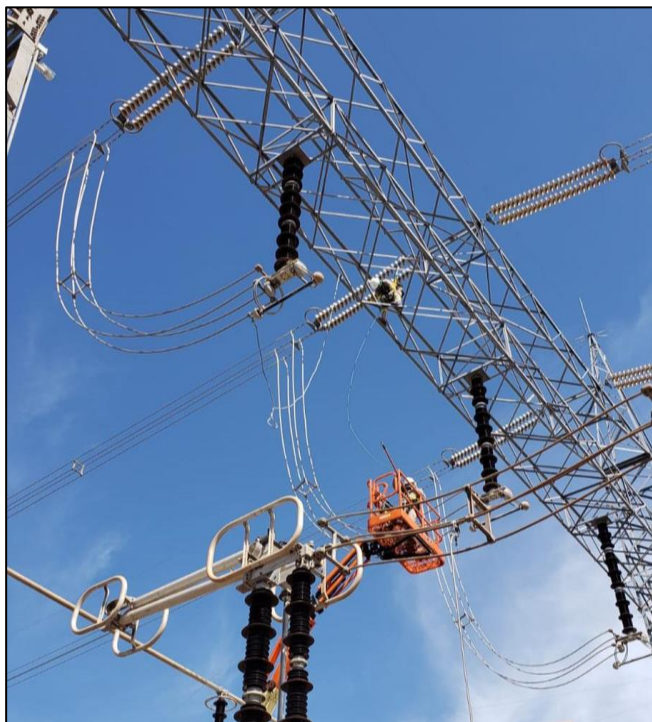
Fig. 9 Arranjo de chaves seccionadoras invertidas nas quais foram instalados os sensores.
