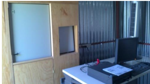
Fig. 11. Panel de control y caseta de control.
