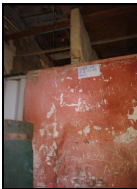
Figura 22. Banheiro interno do casarão localizado no 1.º andar (RJ). Fonte: arquivo da pesquisadora, 2015.
