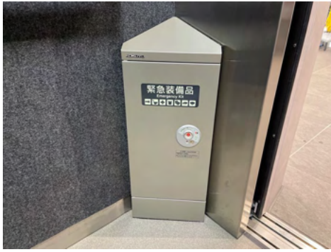
防災キャビネットの設置
