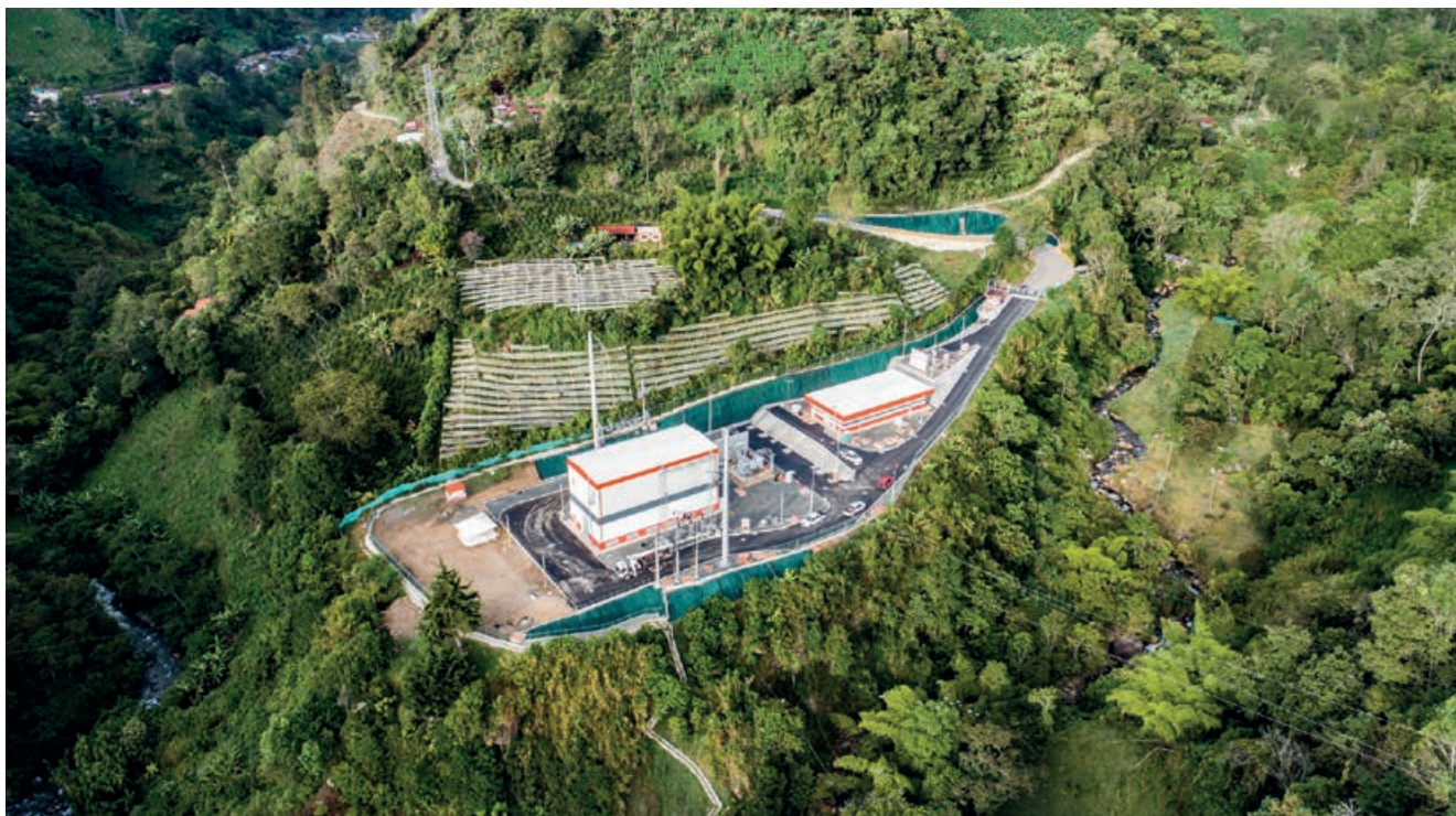
Subestación Cajamarca Tolima
