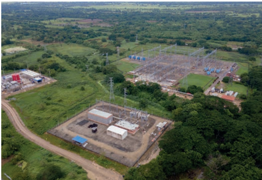
Subestación Bolívar Bolívar
