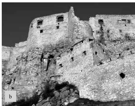
Obr. 3. Spišský hrad. a – pohľad na fragment muríva po zrútení (?) prepoštovej veže so zachovanou severnou stenou a čitateľným miestom napojenia deštruovanej časti na južnej strane k opevneniu hradného jadra. Zdroj Archiv PU SR, T867-03 neg. 69142. b – súčasný stav s rekonštrukciou kruhovej časti muríva veže, nerešpektujúcej pôvodný stav napojenia na južnej strane na opevnenie hradného jadra – objekt paláca. Foto M. Janovská. Abb. 3. Zipsper Burg. a – Blick auf ein Mauerwerksfragment nach Einsturz (?) des Propstturms mit erhaltener Nordwand und deutlicher Anschlussstelle des zerstörten Teils an die Befestigung der Kernburg auf der Südseite. Quelle Archiv des Slowakischen Denkmalmamts, T867-03 Neg. 69142. b – derzeitiger Zustand mit Rekonstruktion des den ursprünglichen Zustand des Anschlusses an die Befestigung der Kernburg (Palasobjekt) auf der Südseite nicht respektierenden runden Mauerwerkteils des Turms. Foto M. Janovská.
