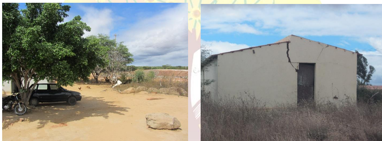
Figura 4 – a) Casa não desapropriada próxima ao canal em Pena Forte-Ce. b) Rachaduras provocadas pelas explosões decorrentes das obras. Setas indicam o canal e as rachaduras nas figuras a e b respectivamente.
