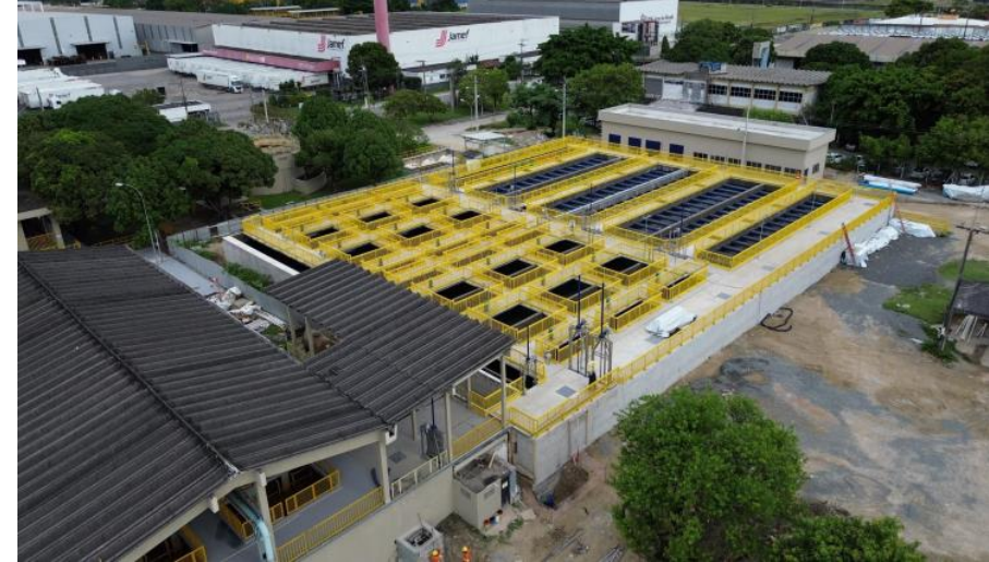
Decantadores e Floculadores
