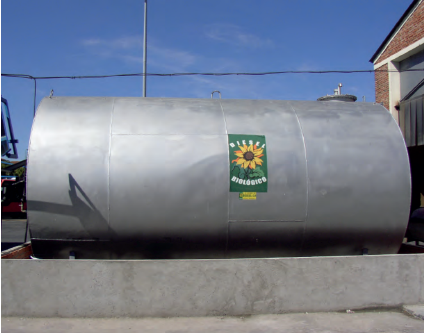
Tanque de biodiésel
