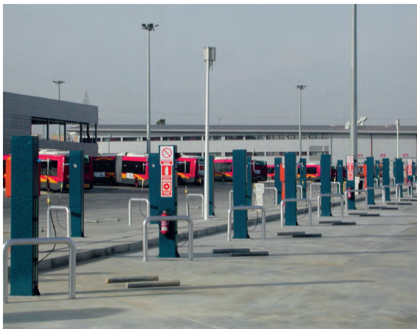
Depósitos de repostaje en una flota de autobuses
