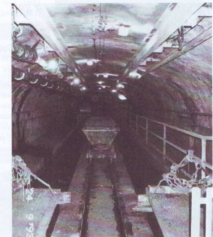
▲ Usine d'Auteuil, bassin double. Voie de 50 : chemin de roulement de la drague sous la voute.
