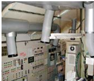
作業場所の空調機設置状況
