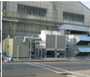
工場建屋全体空調機
