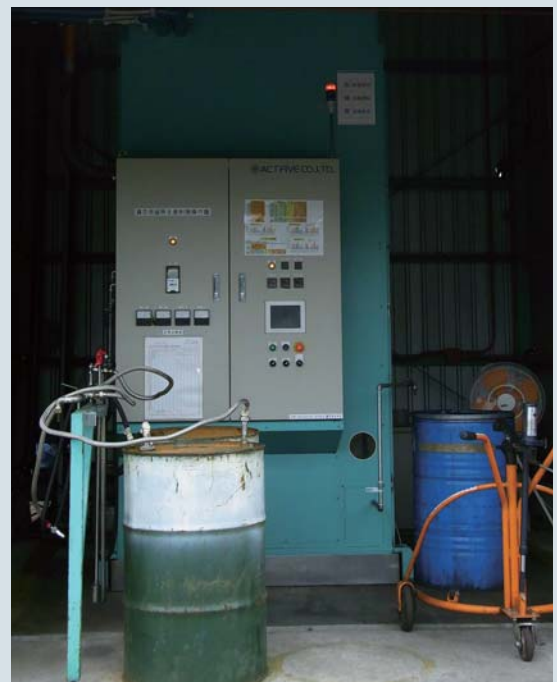
真空蒸留再生装置
