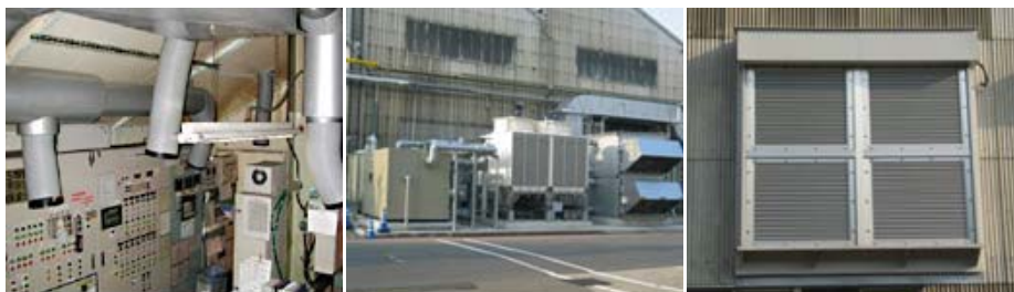
作業場所の空調機設置状況
