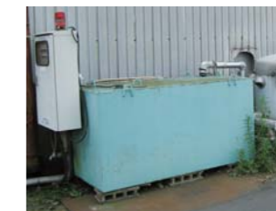
地下水浄化装置
