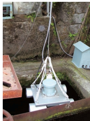
排水口監視システム
