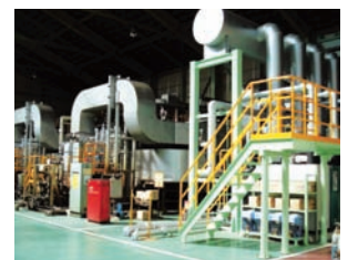
ボイラ室全景
