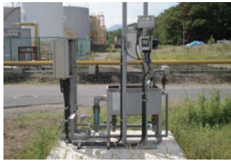
雨水排水監視槽
