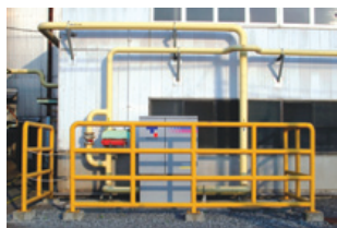
パイプライン接続口(深谷工場)
