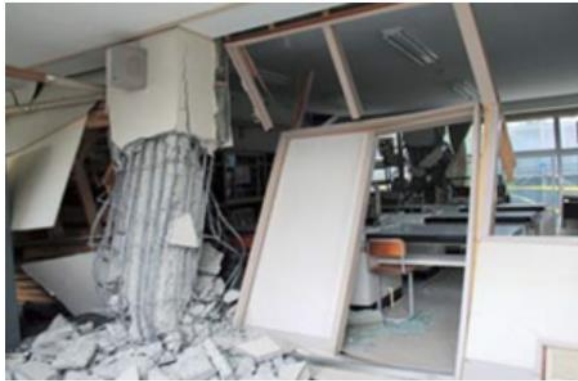
地震により崩壊した教室の柱(福島県福島市)
