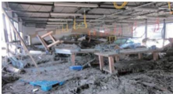
津波により破壊された専修学校の実習室(宮城県岩沼市)
