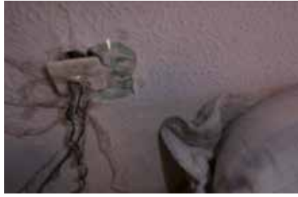
Enchufe detrás de la mesita de noche obsoleto, fuera de cajetín, con derivaciones de circuitos varios conectados sin garantía de conexión y con riesgo de contacto eléctrico e incendio.
