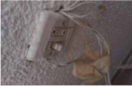
Doble mecanismo, conmutador/enchufe, obsoleto, sin acceso, detrás de la cabecera de la cama con derivaciones no adecuadas de circuitos.
