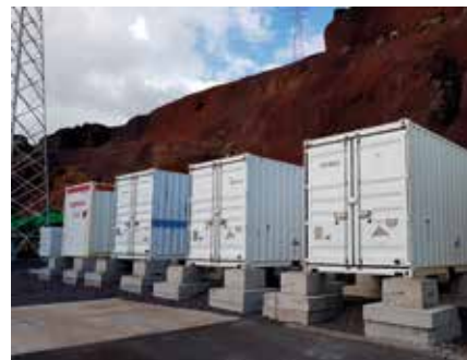
El Hierro: Sistema de Almacenamiento de Energía central de Llanos Blancos en la isla del Hierro.
