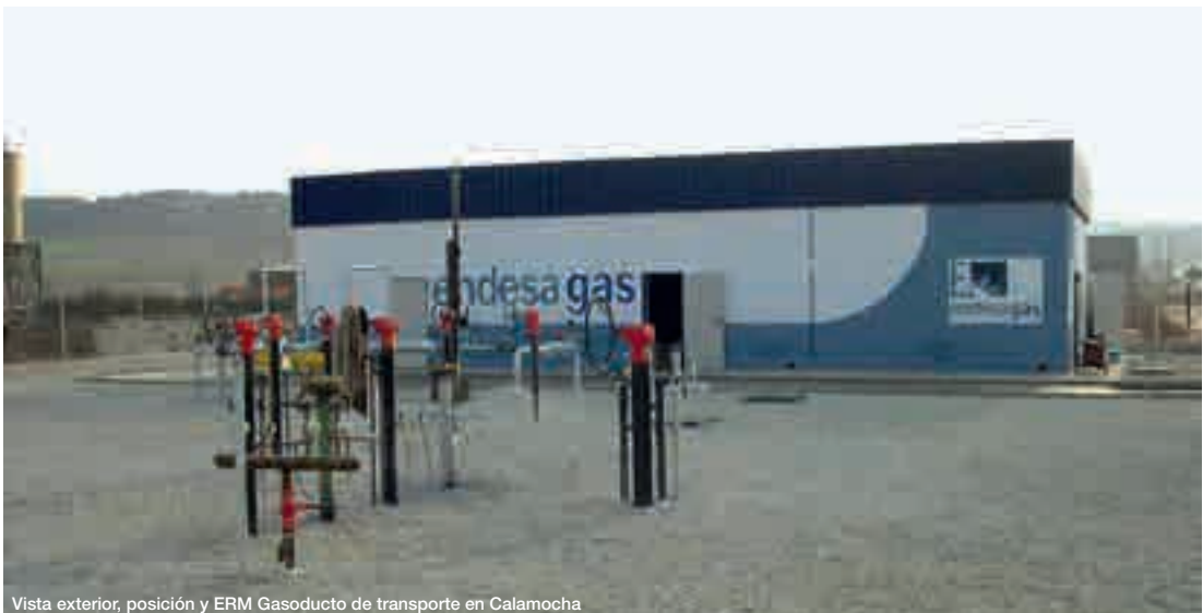
Vista exterior, posición y ERM Gasoducto de transporte en Calamocho
