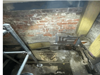
Basement Fan Room
