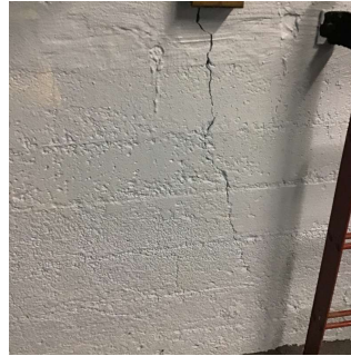
Basement - Fan Area
