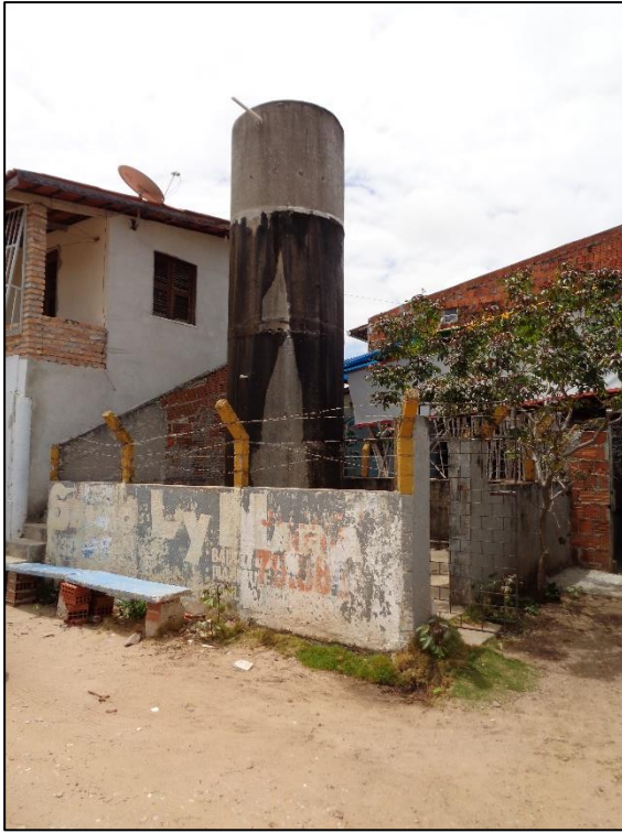
Figura 8.1.2 – Presença de rachaduras, infiltrações e lodo.
