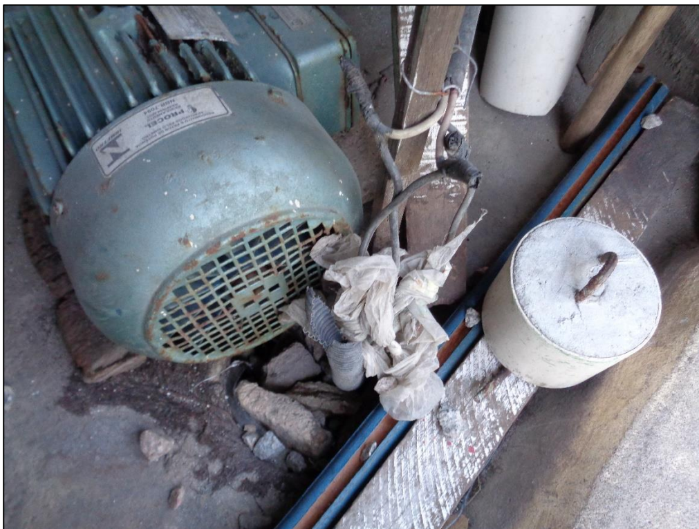
Figura 8.1.4 – Instalações elétricas precárias.
