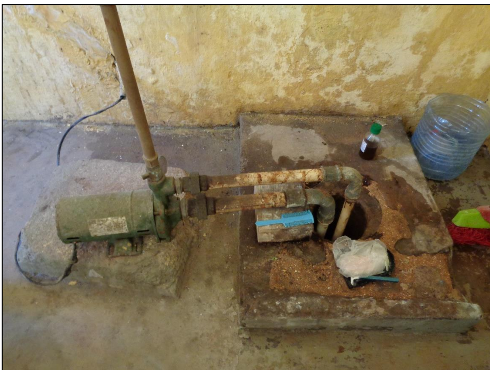
Figura 8.1.5 – Boca de um poço desprotegida sanitariamente.
