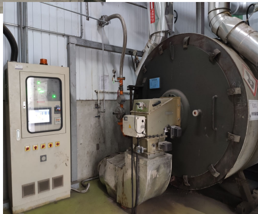
改用低碳鍋爐熱源(重油改天然氣)
