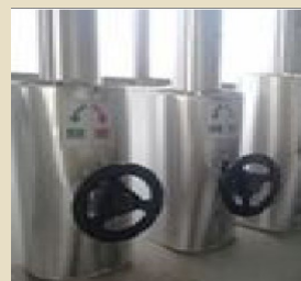
管線標示內容物及流向，閥標示開關方向
